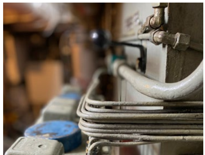
Ein Blick in den Maschinenraum
